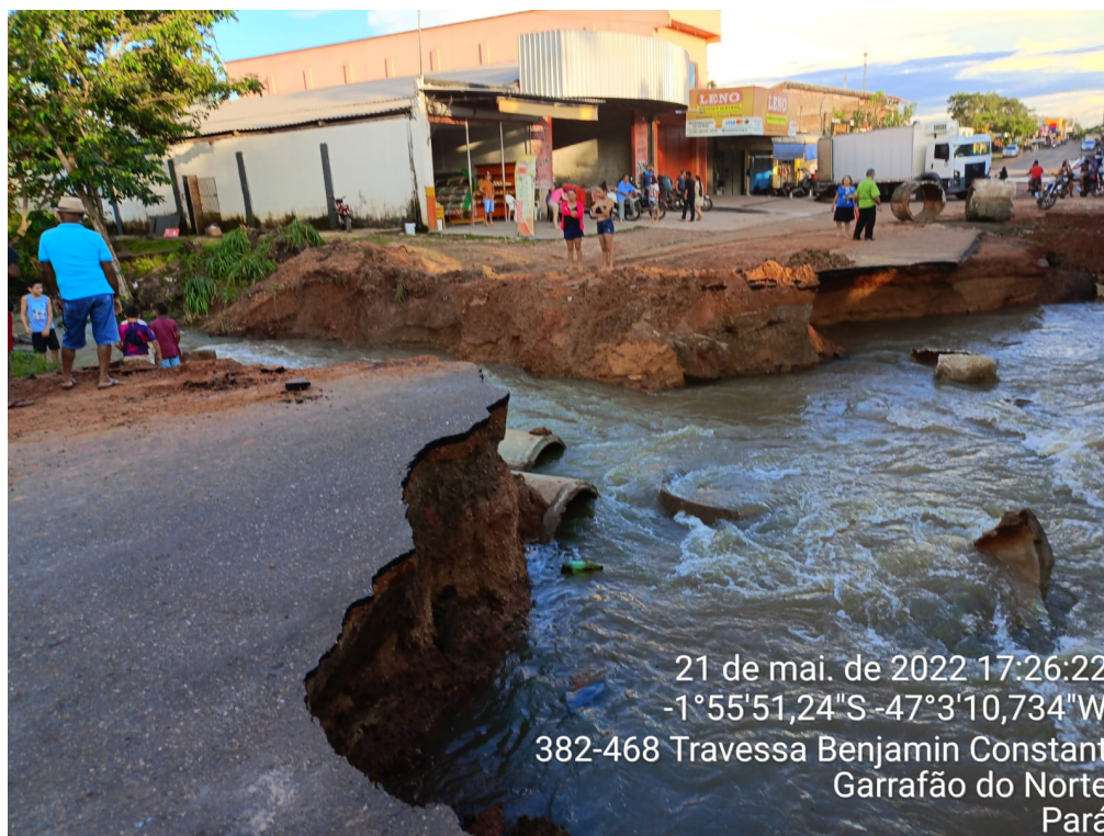
FOTO 2 - Desastre em via pública.
